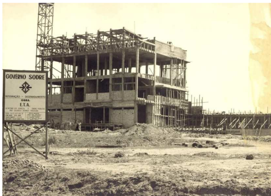
Figura 19 – Estação de Tratamento de Água
